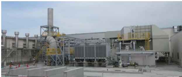
仙台工場に導入したガスタービンコージェネレーションシステム
